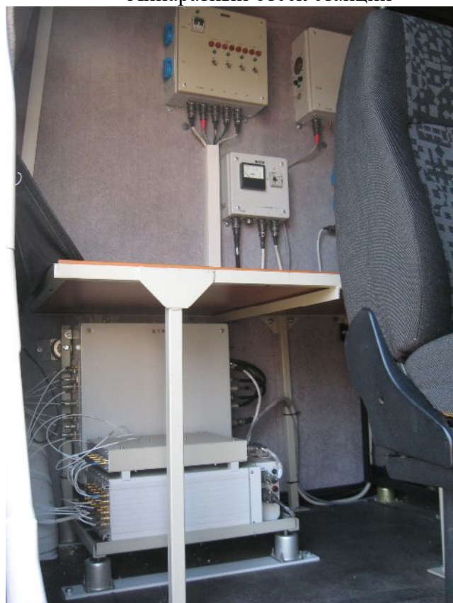
Аппаратный отсек станции
