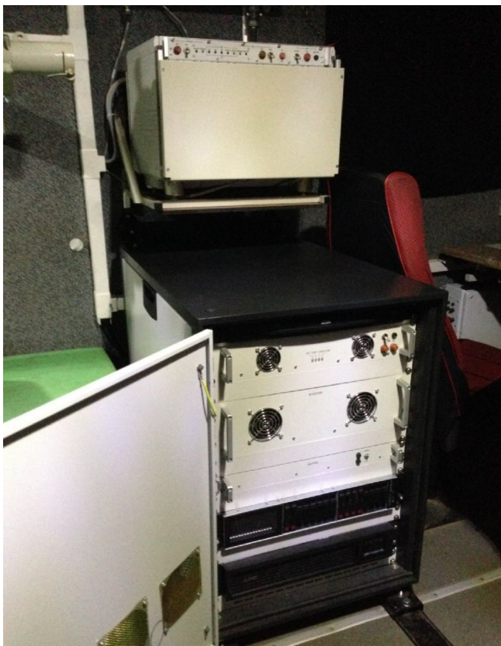
Размещение стойки ПРСШ в составе станции "Барвинок"
