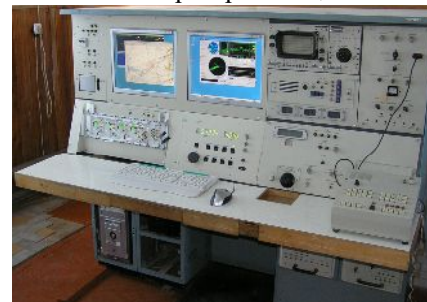
АРМ оператора станции
