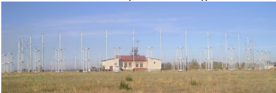
Общий вид объекта размещения РПС «Круг»
