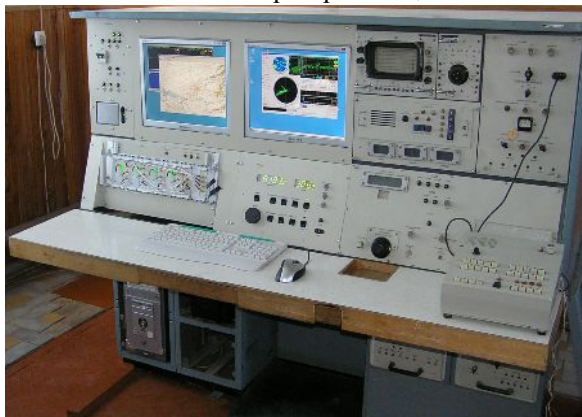
АРМ оператора станции
