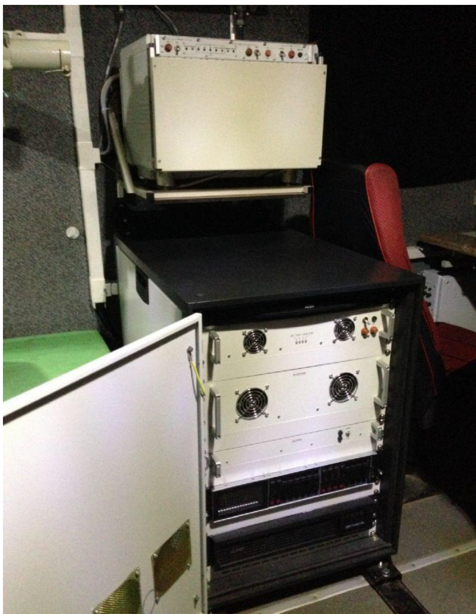
Размещение стойки ПРСШ в составе станции "Барвинок"
